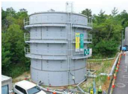
▲仮設タンク稼働中
